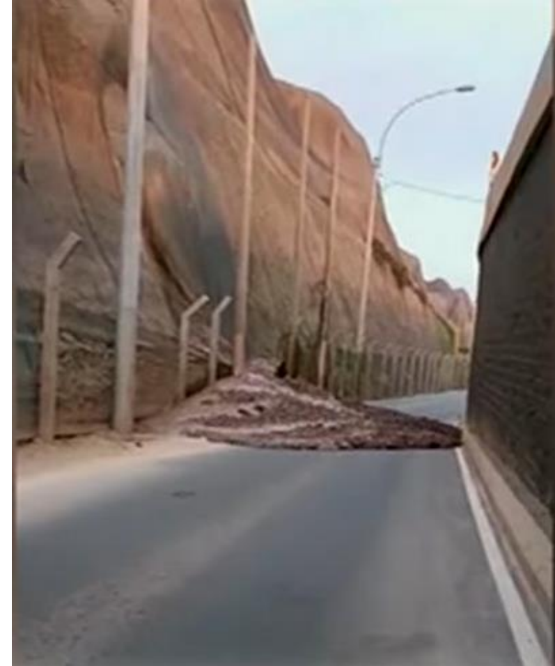
Figura 6. Derrumbe de acantilado en la costa verde.
